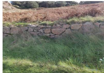
Muret en granite rose, Landes de Ploumanac'h - Ploumanac'h © MM
